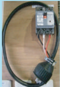
《発電機接続プラグ》
